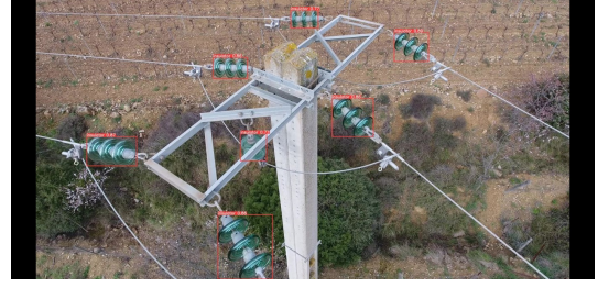
FIGURE 1 – Exemple de détection d'isolateurs par Yolov5m6.
