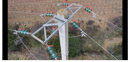
FIGURE 1 – Exemple de détection d'isolateurs par Yolov5m6.
